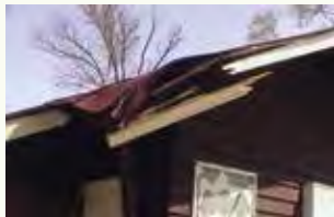
補修が必要になった屋根
