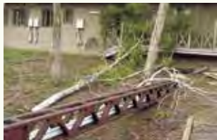
台風により折れてしまった白樺により 補修が必要になった手すり
