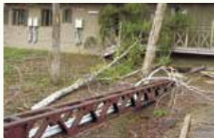
台風により折れてしまった白樺により 補修が必要になった手すり
