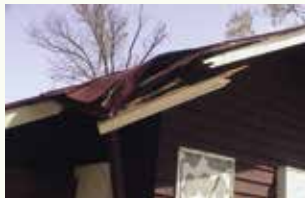
補修が必要になった屋根
